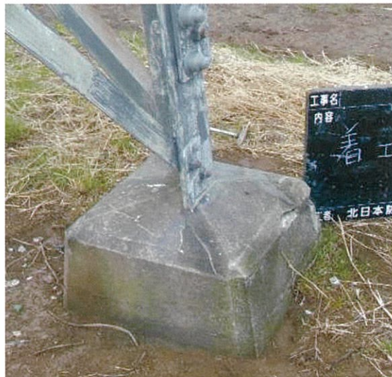
状況写真より、コンクリート基礎部にクラックの発生や玉砂利が見られる。
